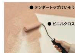
ビニルクロスに上塗りOK! 室内環境の改善やお部屋のイメージアップに、簡単に塗り替えてできるリフォーム材。
